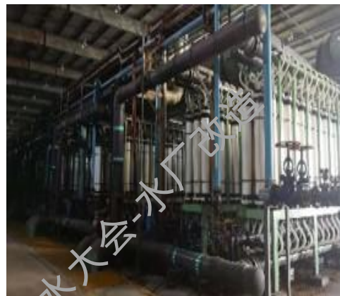
海水淡化处理
