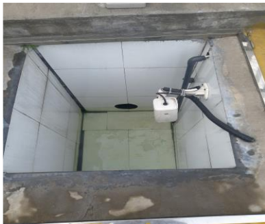
柯桥区钱清街道 九岩终端出水口
