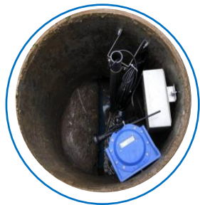
窨井监测RTU系统
