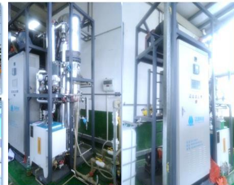
电镀镍废水 (蒸发量100kg/h) 一体化MVR项目 ◆ 广州
