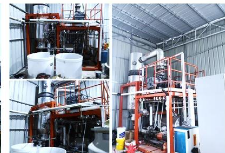
含镍废水 (蒸发量0.5t/h) 一体化MVR项目 ◆ 广东环集
