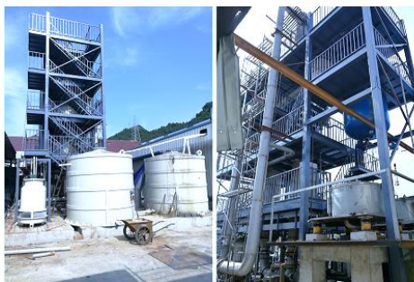
硫酸锂和硫酸钠溶液蒸发结晶 工程MVR项目 ◆ 湖南顺华锂业有限公司
