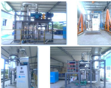
电路板废水 (蒸发量0.5t/h) 一体化MVR项目 ◆ 广东东莞
