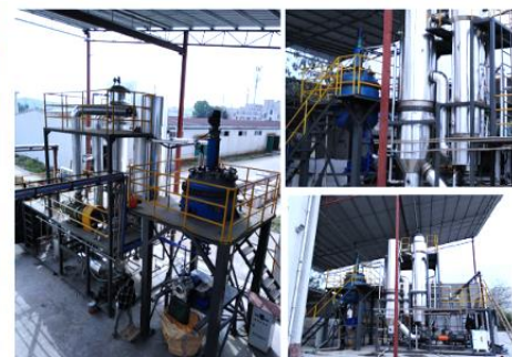
高盐高COD废水 (蒸发量1t/h) 一体化MVR项目 ◆ 广东韶关
