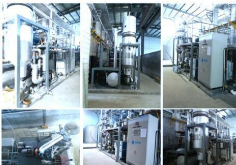
硫酸钴废水 (蒸发量0.5t/h) 一体化MVR项目 ◆ 江西南城
