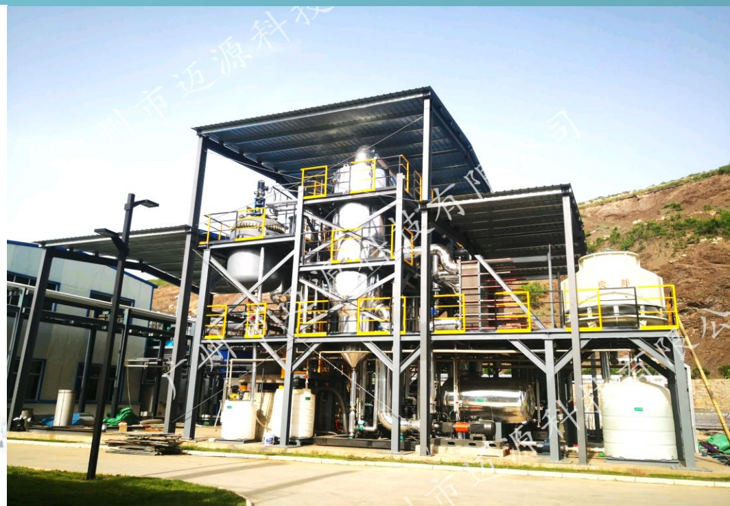
山东10T/h 化工废水处理项目
