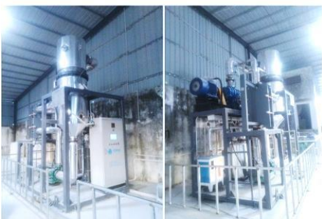
电路板废水 (蒸发量0.5t/h) 一体化MVR项目 ◆ 广东东莞
